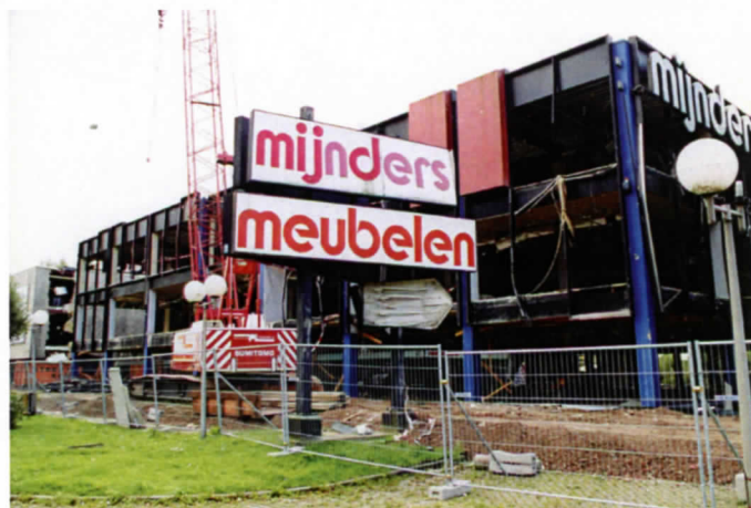
De laatste foto voor de definitieve sloop van 'Mijnders Meubelen' op 'De Sniep' in Diemen (foto 2001, Gerrit Hols)
