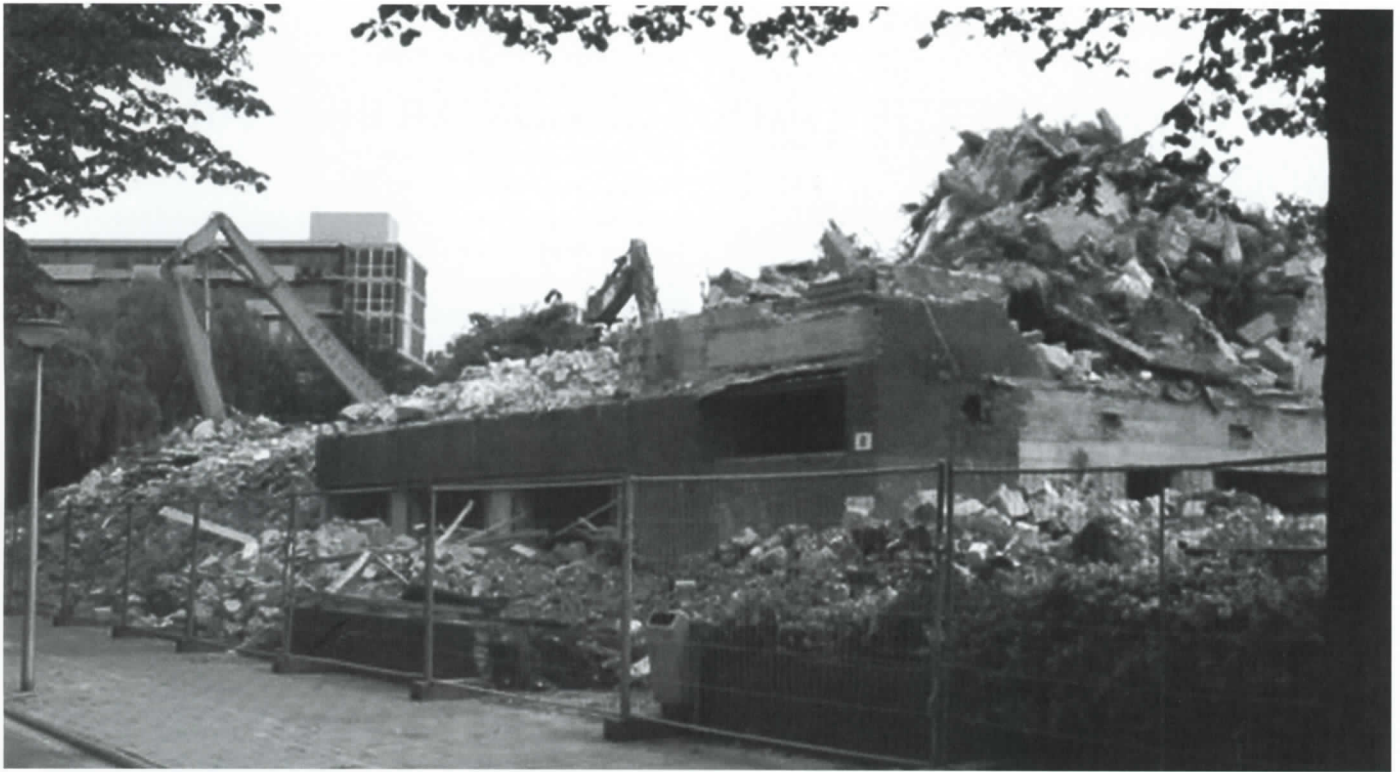
De sloop van het oude gebouw van 'De Diem' aan de Ouddiemerlaan 110 (foto Henk Teiwes 2010).
