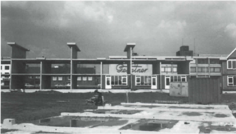
Rond 1987 is de Anne Frankwijk op het oude sportterrein achter de Hervormde kerk in aanbouw. Op de voorgrond de fundering voor de Kerwin Lucasstraat. De bouw aan de Prins Hendrikkade is al gevorderd. Daarachter is het Gestetner-gebouw aan de Muiderstraatweg te zien (foto Peter Prins).
