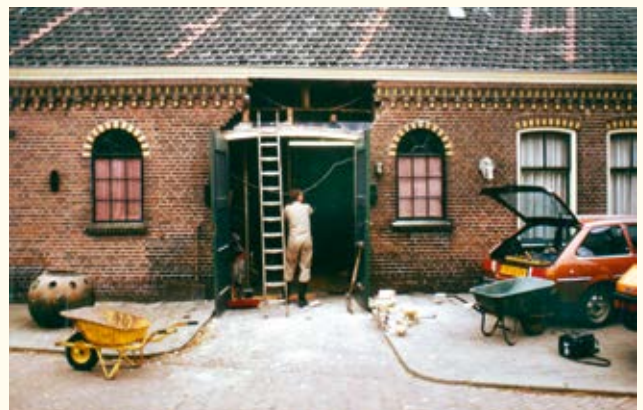
Herstel van de schade die de zware, veel te hard rijdende vuilniswagens, aanrichtte aan de gevel van het zomerhuis. De gemeente trad niet op tegen het illegale gebruik van de Ouddiemerlaan.
