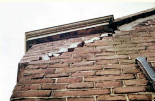
Schade aan het hoofdgebouw die veroorzaakt werd door trillingen van voorbij denderende vuilniswagens op de smalle Ouddiemerlaan die daarop geheel niet berekend was.
