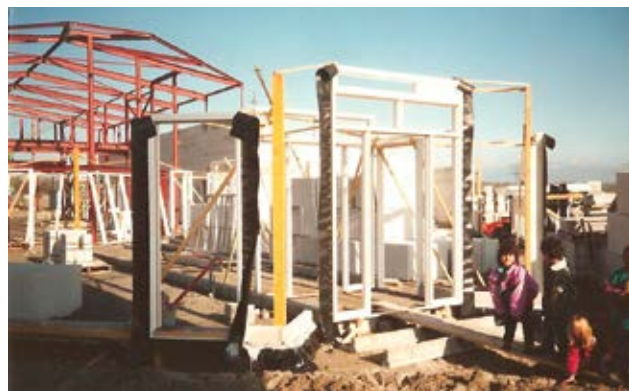
De bouw van 't Palet aan de Rietgors in het voorjaar van 1991 (foto H. Hogenaar).
